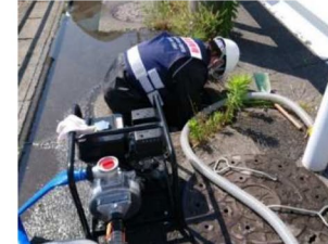
空気弁からの漏水対応
