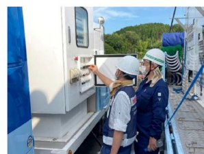
ポンプ車の維持管理
